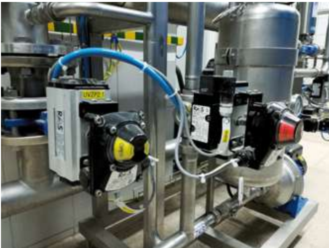
Zestawy zautomatyzowane RQS z wykorzystaniem skrzynek wyłączników krańcowych oraz elektrozaworów NAMUR, montowanych bezpośrednio na korpusach napędów pneumatycznych.
