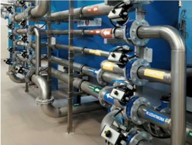
Stacja uzdatniania wody z wykorzystaniem przepustnic serii 376 firmy OMAL zautomatyzowanych napędami krzywkowymi dwustronnego działania.
