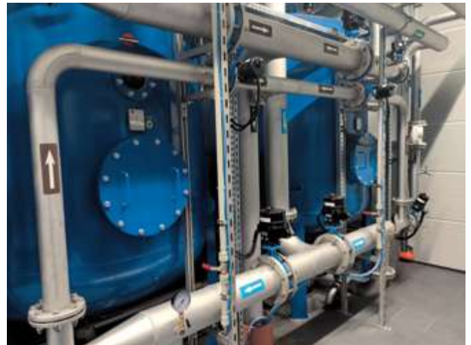
Stacja uzdatniania wody zautomatyzowana na napędach elektrycznych ON-OFF i modulowanych firm RQS-FLOWINN.
